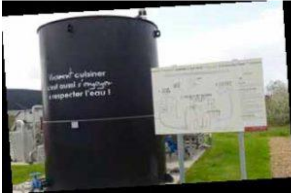
Station de traitement des eaux
